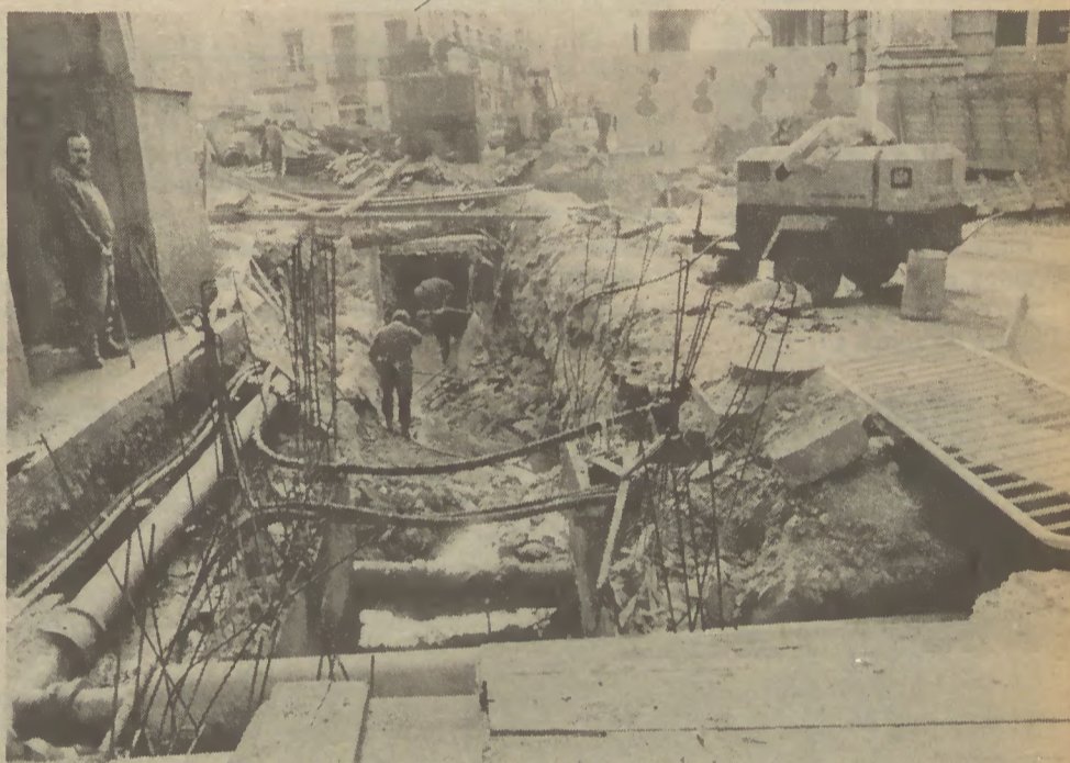
Rua das Portas de Santo Antão: aqui o novo colector das águas pluviais vai ter o quádruplo da capacidade
