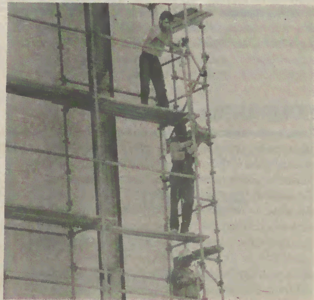
É uma constante a violação de normas de protecção dos trabalhadores
